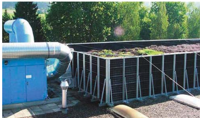
Biofilter-Anlage auf dem Firmendach
